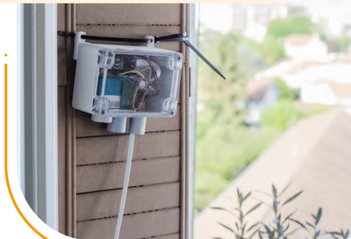
Micro-station fabriquée chez Atmo Auvergne-Rhône-Alpes et installée chez un particulier
