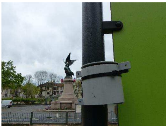
Tube installé dans sa boîte de protection
