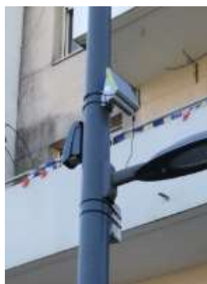
FIGURE 4 : EXEMPLE DE MICRO-CAPTEUR INSTALLE SUR LE TRACÉ DU TRAM
