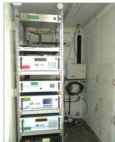
Mesures continues embarqués du laboratoire mobile (Nox, PM10)
