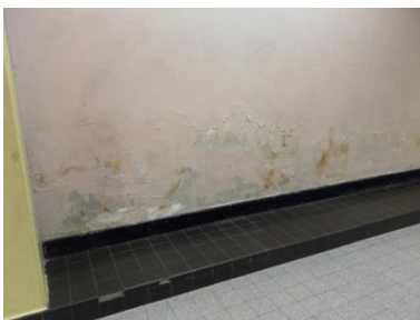
PRESENCE DE MOISSURES SUR LES MURS.
