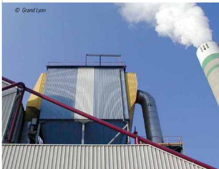
Système de traitement des fumées
