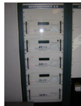
Intérieur du camion laboratoire
