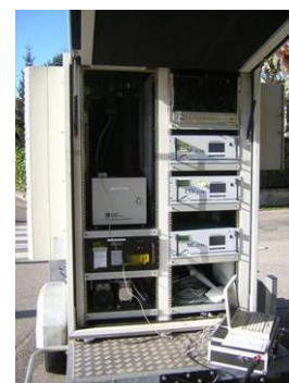
Intérieur de la remorque laboratoire(▲)
