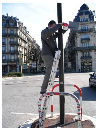
Installation de tubes à diffusion sur le boulevard Gambetta
