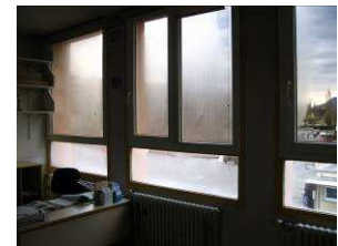
Photo n° 7 : condensation sur les fenêtres de la salle de classe.
