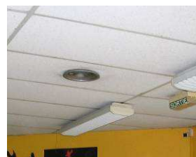
Photo 5 : bouche d'entrée d'air
