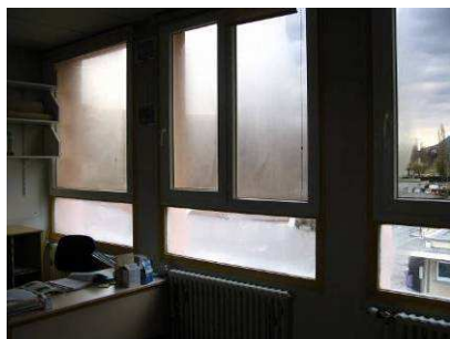
Figure 10: Humidité sur les fenêtres liée au manque d'aération.
