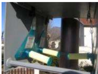
Tubes BTX installés dans leur boite de protection
