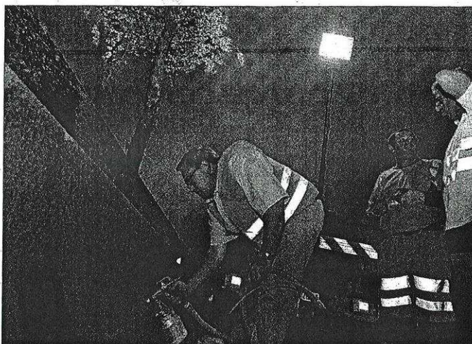
Hier soir, un produit a été projeté sur les murs anti-bruit de la rocade Sud. Ce revêtement a des propriétés dépolluantes et fera l'objet d'analyses en septembre prochain. Le DL / Frédéric VERHAEGHE
