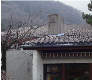
Photo 1 : La cheminée de la chaufferie (école de Veurey Voroise).
