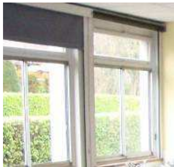
Figure 9: Fenêtres non étanches et permettant l'entrée d'air neuf à La Tronche.
