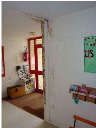
Photo 11 : Humidité sur les murs.
