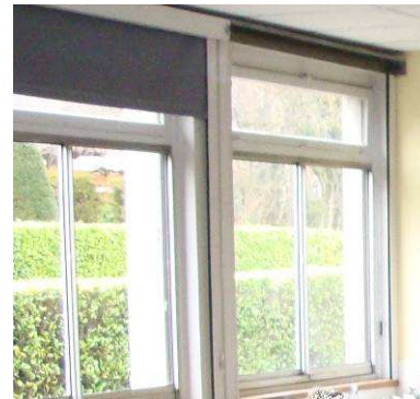
Photo 25 : Les fenêtres ne sont pas étanches.
