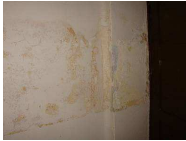
Photo 17 : Humidité sur les murs.
