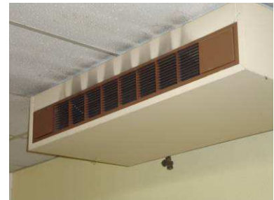
Photo 21 : Un radiateur de chauffage.
