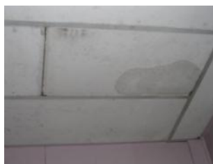
Figure 8 : Humidité sur un plafond.
