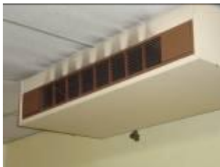
Figure 4 : Installation de chauffage mal entretenue .
